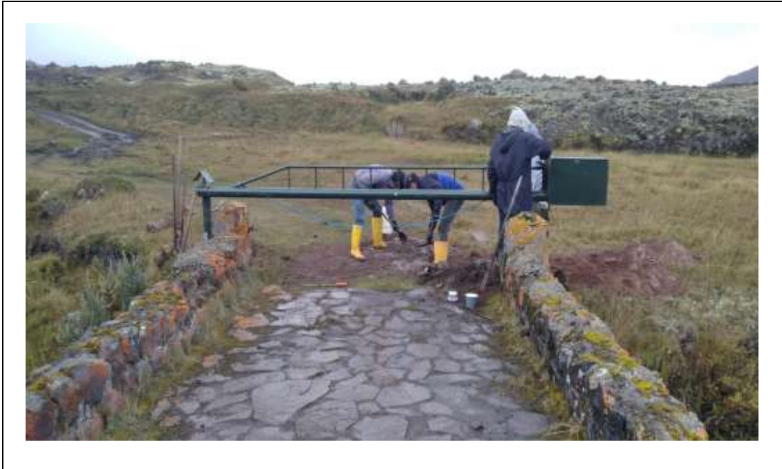
Instalación de controles de acceso en puntos vulnerables.
