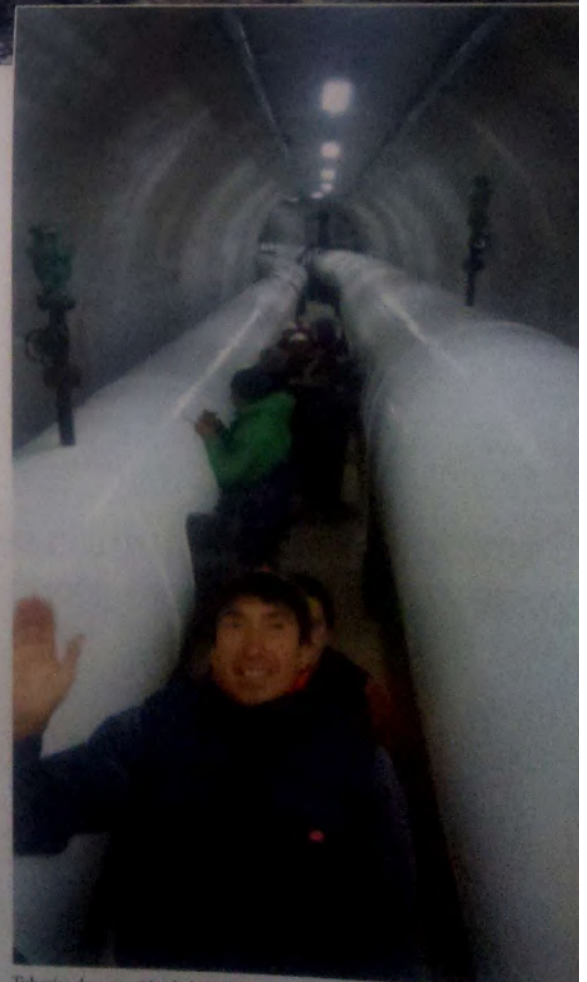
Tuberías de captación de la EPMAPS
